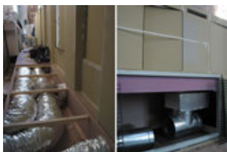
Conductes que insuflen aire condicionat a la humitat i temperatura desitjades dins una gran vitrina.
