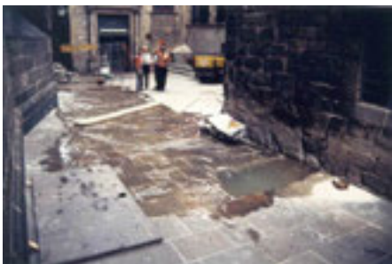
Les àrees arqueològiques sota la cota de carrer requereixen la vigilància del segellat del paviment i el control de la xarxa d'aigua i clavegueram.
