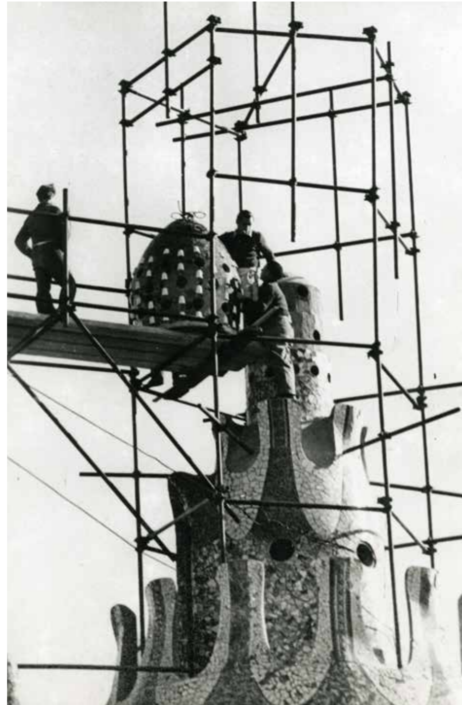
Posant el coronament de la coberta de la Casa del Guarda. Càtedra Gaudí
